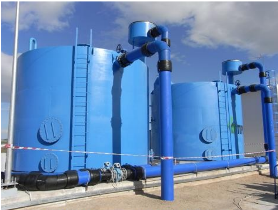
Το διυλιστήριο της ΔΕΥΑΘ στον Μόρνο
